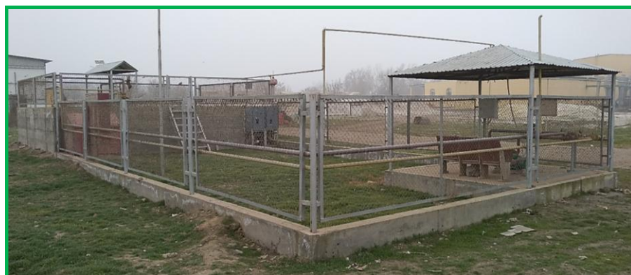
Рис. 7. Общий вид установки для сушки хлопка-сырца с применением в качестве энергоносителя сжиженный углеводородный газ, реализованной на Баяутском хлопкозаводе Сырдарьинской области
