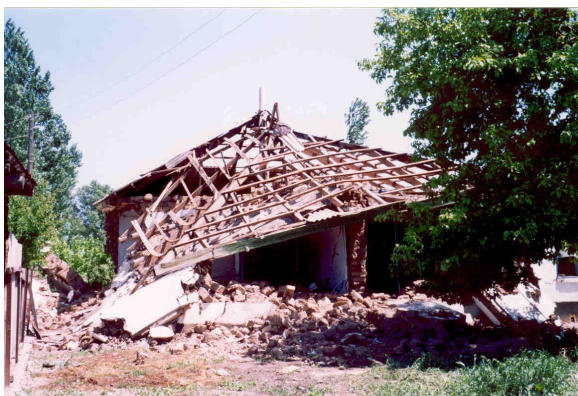
Рис. 1. Обрушение стен и кровли жилого дома на станции Луговая
