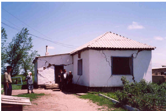
Рис. 2. Разрушения части стен жилого дома на станции Луговая
